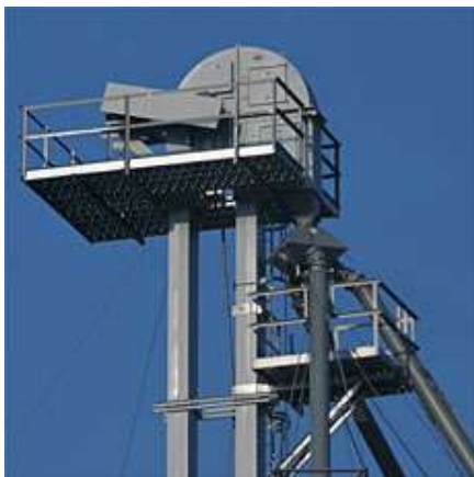
Figura 2 – Elevador de Caçambas
